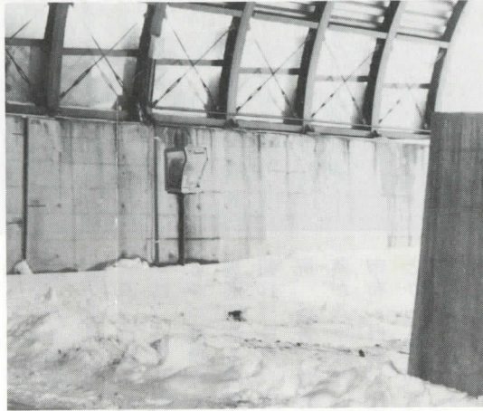
スノーシェルター内に設置された公衆電話
